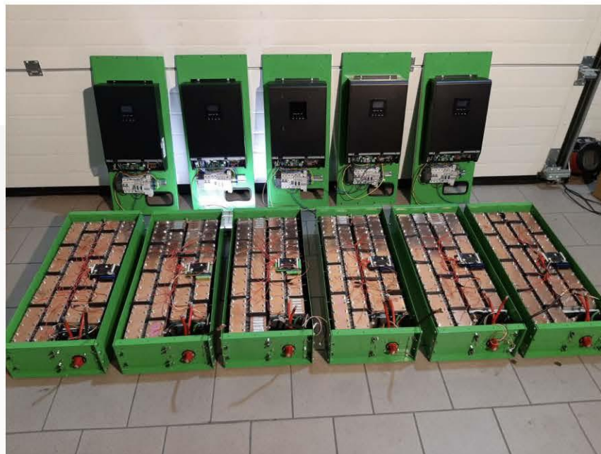
Magazyny energii do bilansowania sieci elektroenergetycznej
